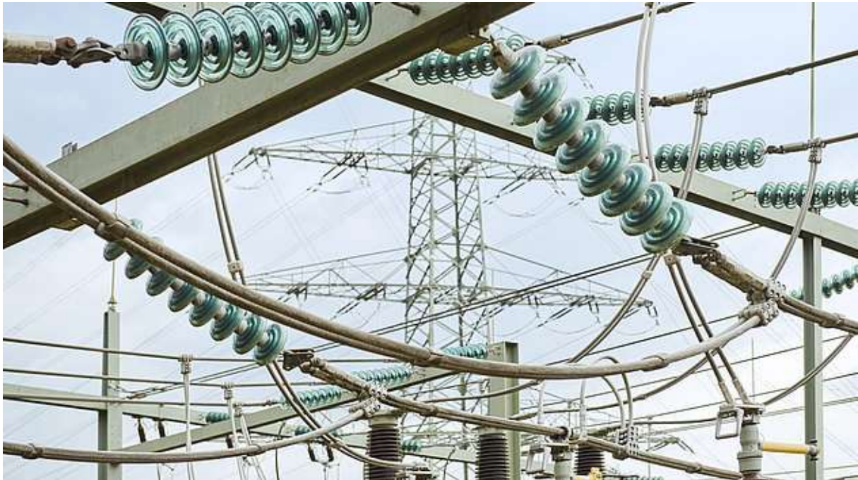
Umspannanlage von Westenergie. Bild: Westenergie 12. März 2024
